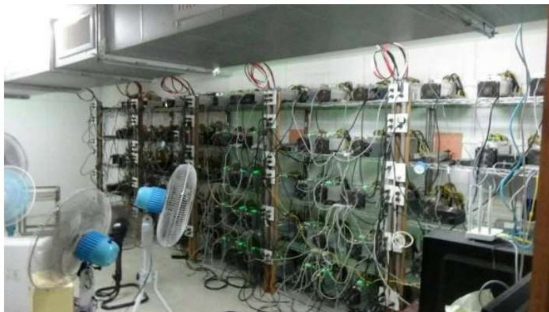
台電在嘉義縣東石鄉黃石吟自家鐵皮屋查獲比特幣挖礦機房。(記者丁偉杰翻攝)
